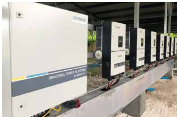
03 Die Universal Power Plattform von Dhybrid ermöglicht die intelligente Kombination und Steuerung von Batteriespeichern und erneuerbaren Energien in hybriden Stromanwendungen
